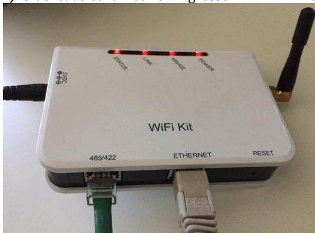
Figura 91 – Cavo ethernet connesso al datalogger
