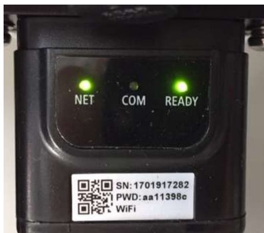
Figura 52 - Stato di comunicazione irregolare tra inverter e scheda
