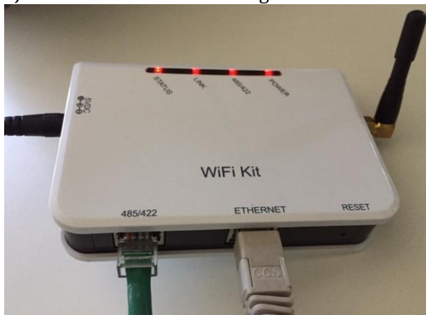
Figura 85 – Cavo Ethernet collegato al datalogger
